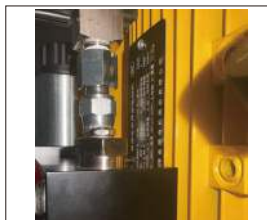
检查泵体铭牌，确认标注电压 220V/50HZ
