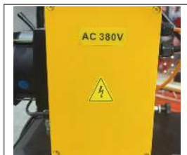
检查电控箱体，确定额定电压。
