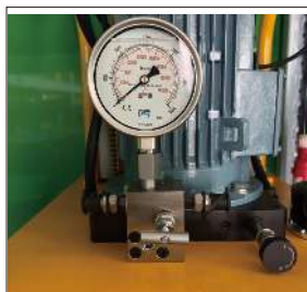
卸压时缓慢拧松卸荷阀，将系统压力降低到压力表示数 0。
