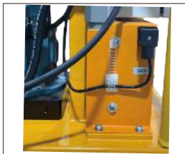
检查电控箱体，确定额定电压。
